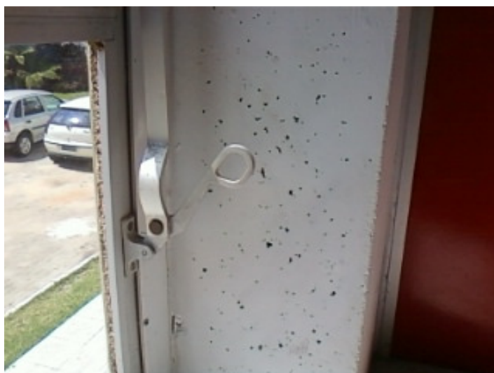
Foto 51 – Marcas na alvenaria.
