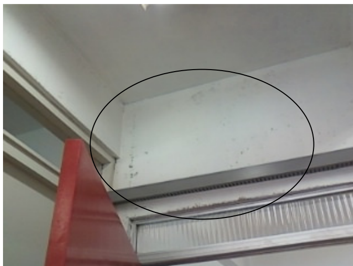
Foto 41 – Furos na alvenaria.
