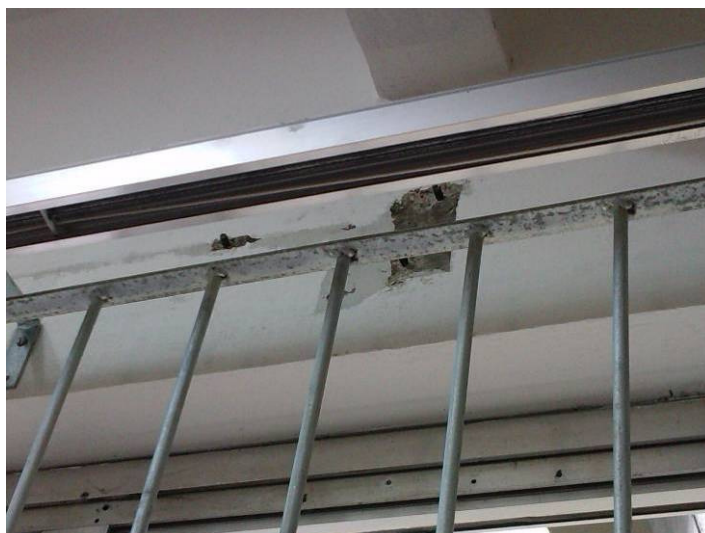
Foto 83 – Descolamento de reboco.
