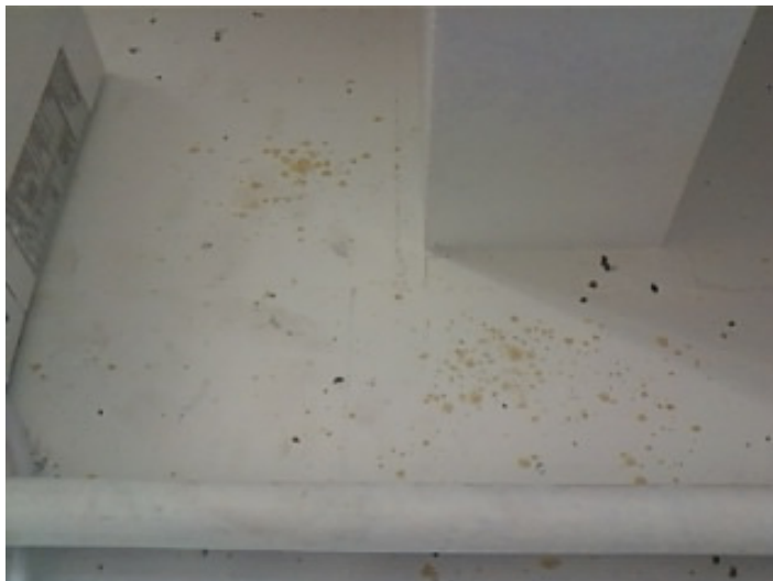
Foto 70 – Manchas na viga.
