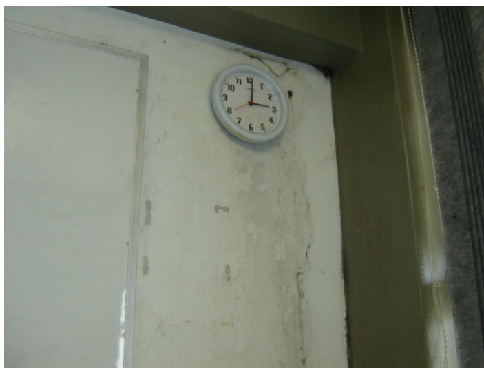
Foto 114 – Parede com infiltração.
