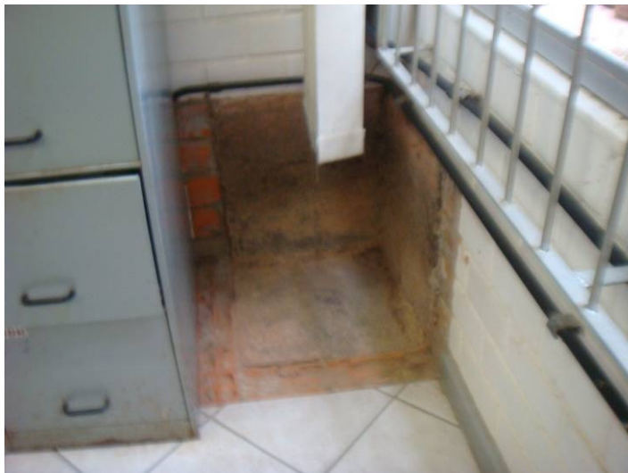
Foto 16 – Infiltração e falta de pintura.
