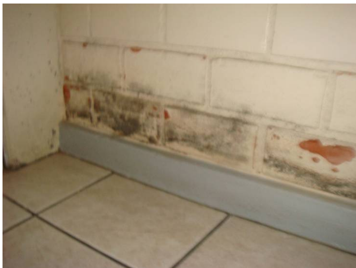
Foto 08 – Mofo na parede devido à infiltração.
