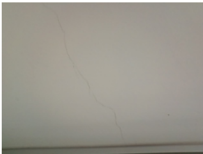
Foto 112 – Fissura na laje superior.
