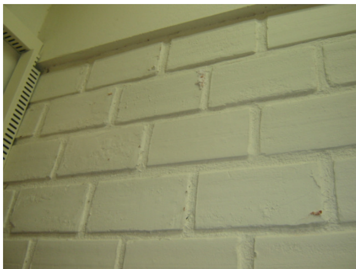
Foto 122 – Tijolos com infiltração.
