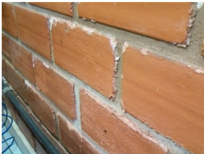
Foto 63 – Infiltração pela parede.
