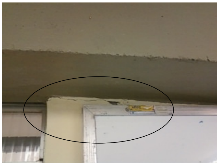
Foto 60 – Fissura de 2,15m.
