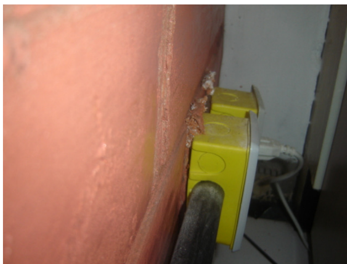
Foto 87 – Tijolo com umidade.
