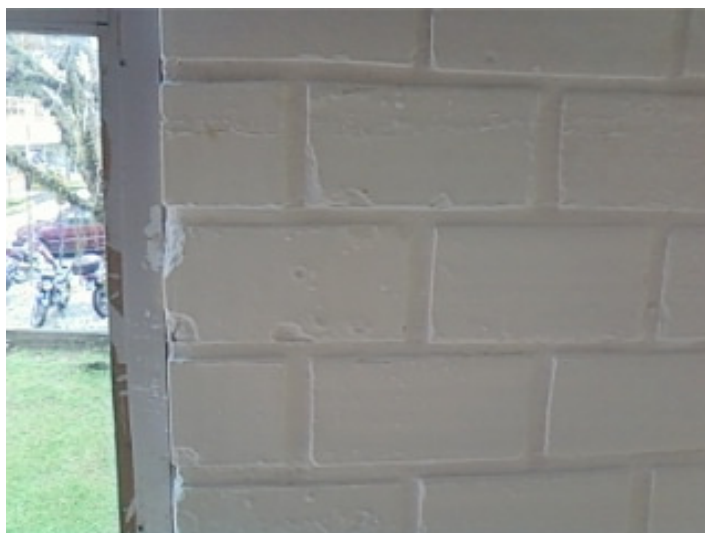
Foto 96 – Tijolos com infiltração.
