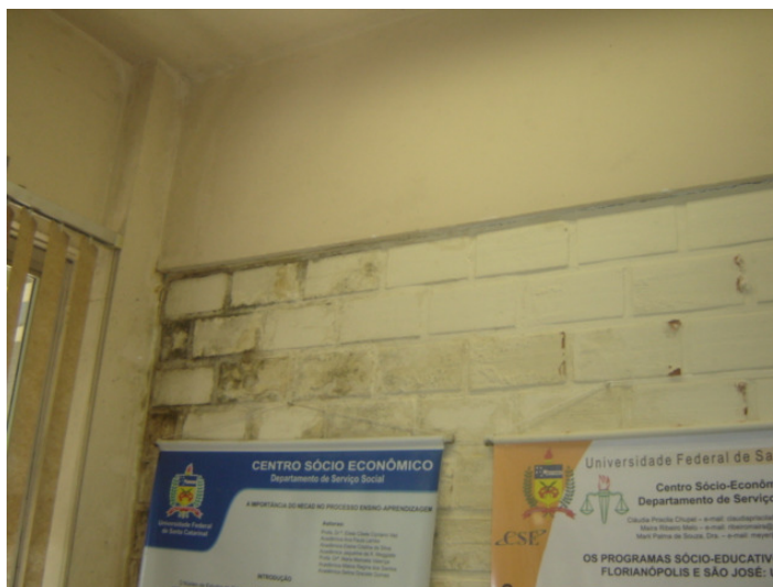
Foto 117 – Infiltração na parede.
