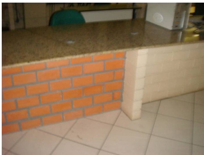
Foto 11 – Falta pintura na bancada.
