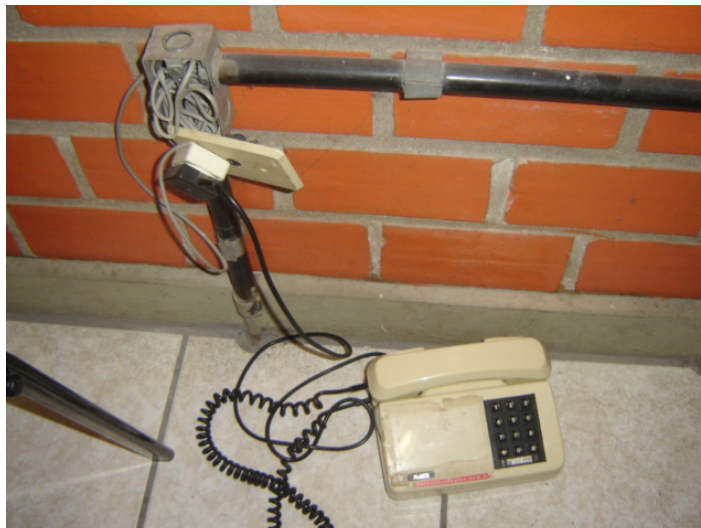
Foto 132 – Caixa de passagem com espelho danificado.
