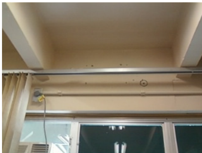
Foto 64 – Espera do ar condicionado.
