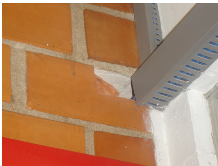
Foto 67 – Furo no tijolo para ser vedado.
