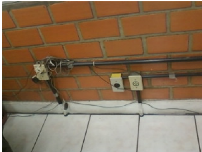
Foto 38 – Fios arranjados de maneira inapropriada.
