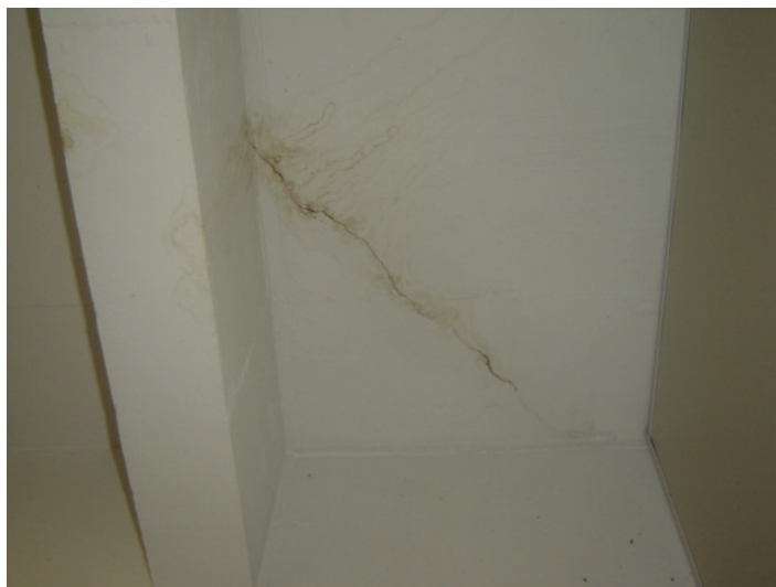
Foto 110 – Manchas causadas pela infiltração.
