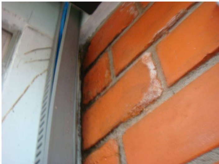
Foto 01 – Tijolo danificado e com ramificação de vegetação.
