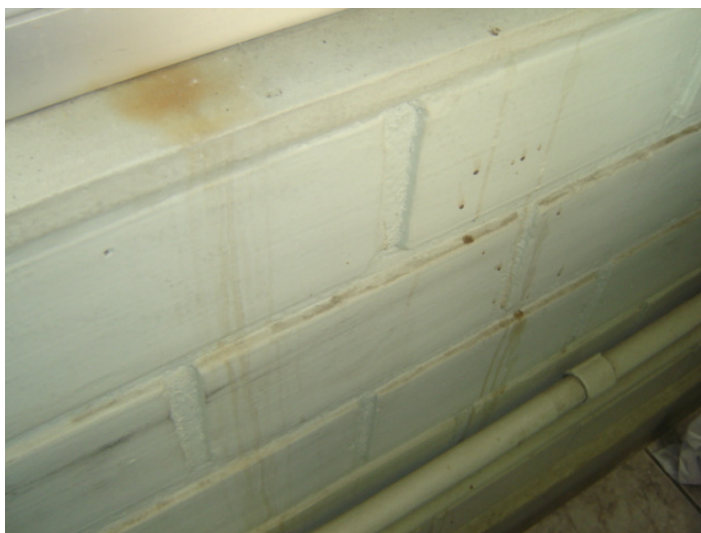
Foto 77 – Infiltração no peitoril.
