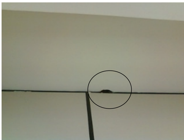
Foto 23 – Viga com danos
