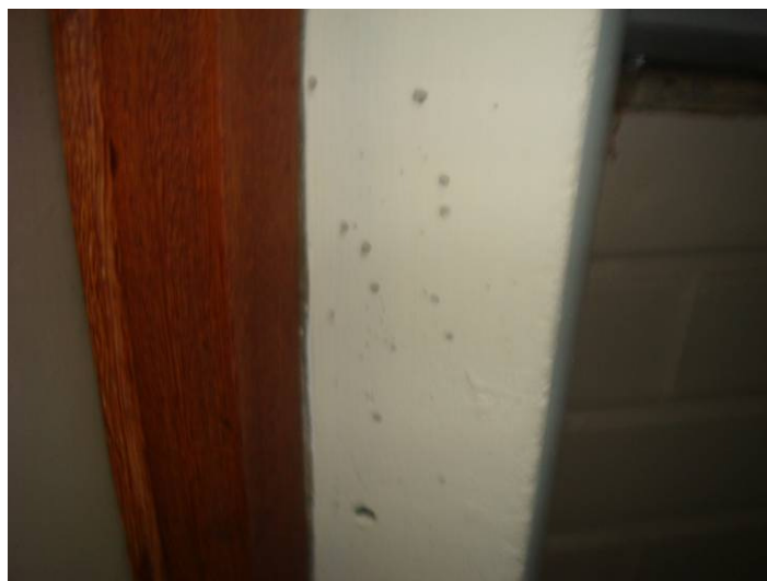
Foto 14 – Marcas na alvenaria.
