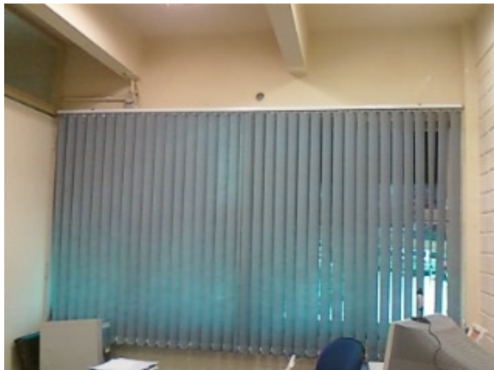
Foto 65 – Espera do ar condicionado.
