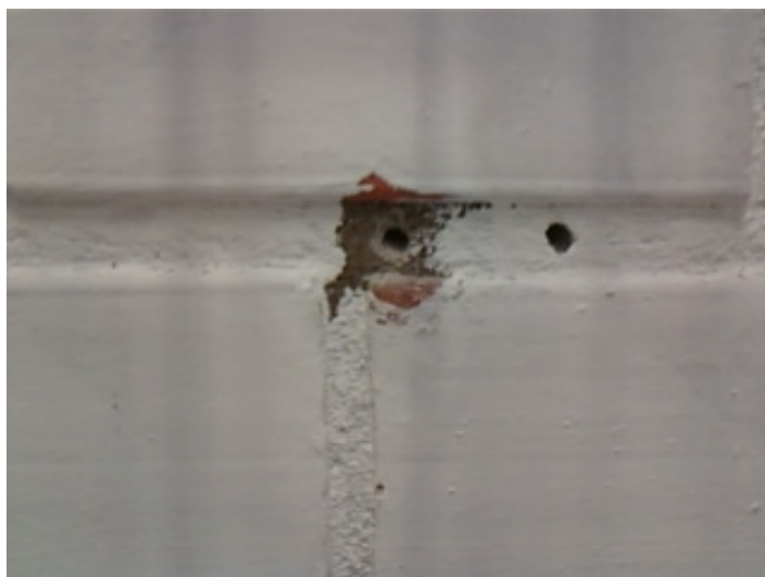
Foto 53 – Marcas na alvenaria.
