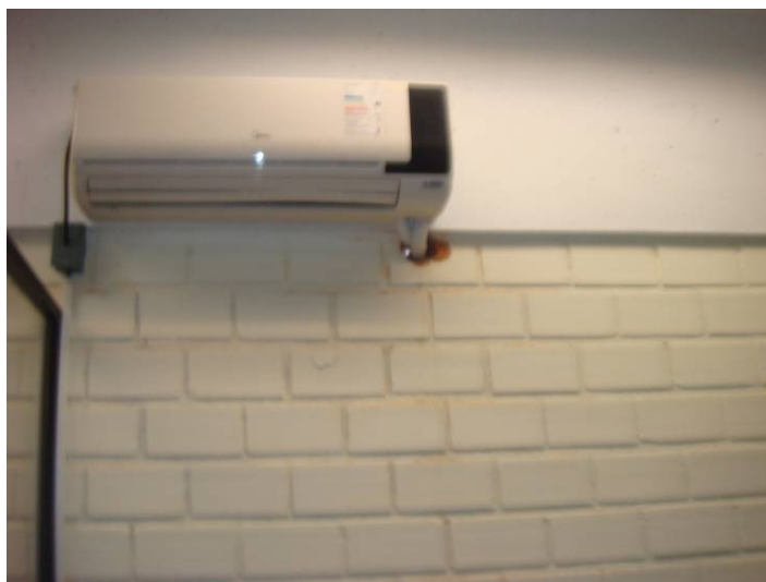
Foto 21– Furo na parede.
