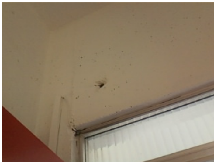
Foto 59 – Furo na parede.
