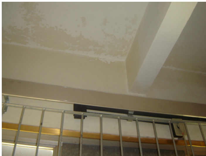
Foto 88 – Manchas e infiltração na alvenaria.
