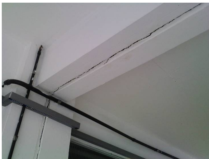
Foto 98 – Fissura na junta de ligação no pilar e na viga.
