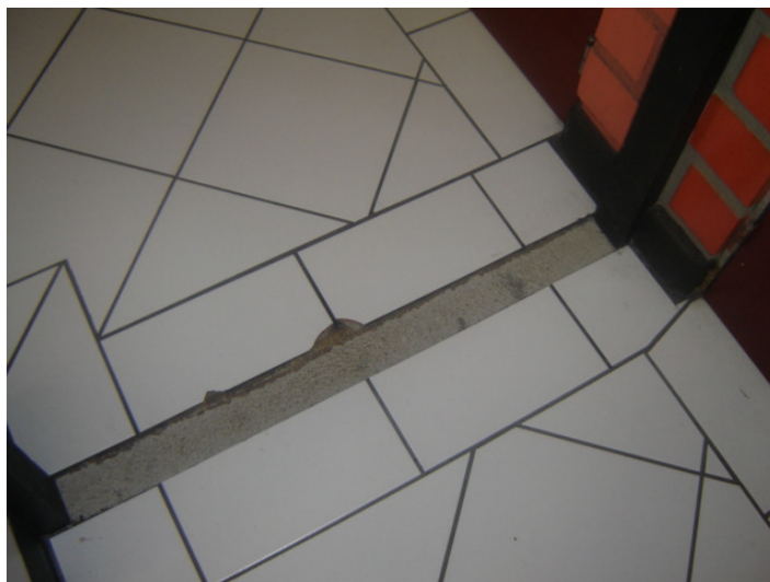
Foto 84 – Piso cerâmico quebrado.
