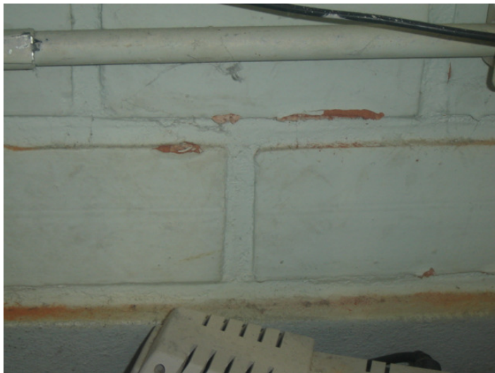
Foto 78 – Infiltração nos tijolos.
