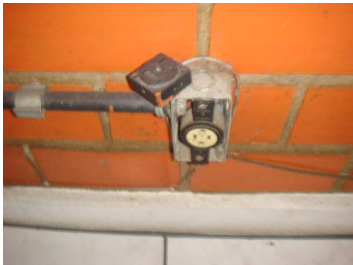
Foto 45 – Caixa de passagem com espelho faltando.
