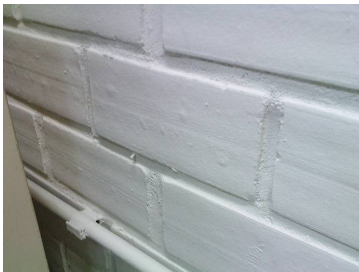
Foto 90 - Infiltração nos tijolos.
