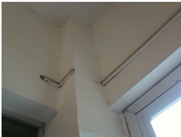
Foto 74 – Furo na parede de retirada de calha.
