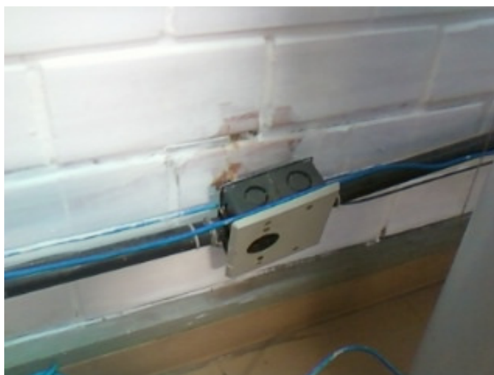
Foto 113 – Caixa de passagem solta da parede.
