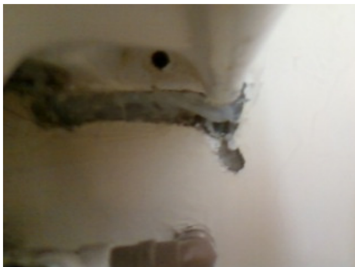
Foto 27 – Descolamento do reboco.
