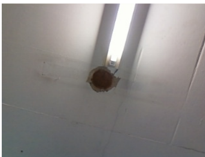
Foto 32 – Furo e marcas na laje
