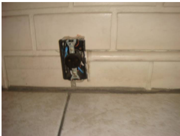
Foto 02 – Caixa de passagem sem espelho.
