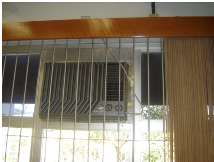
Foto 86 – Placa de alumínio em torno do ar condicionado.
