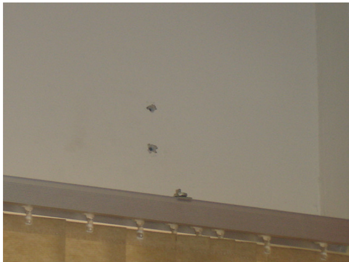
Foto 133 – Furos na alvenaria.
