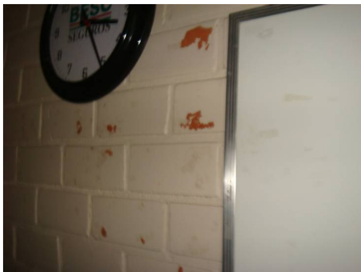
Foto 15 – Descolamento de tinta.
