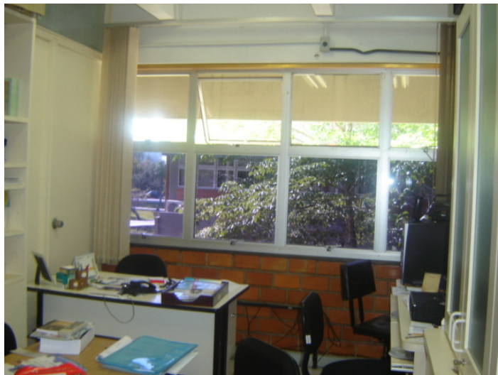
Foto 66 – Paredes sem pintura e vista dos vidros sem película.
