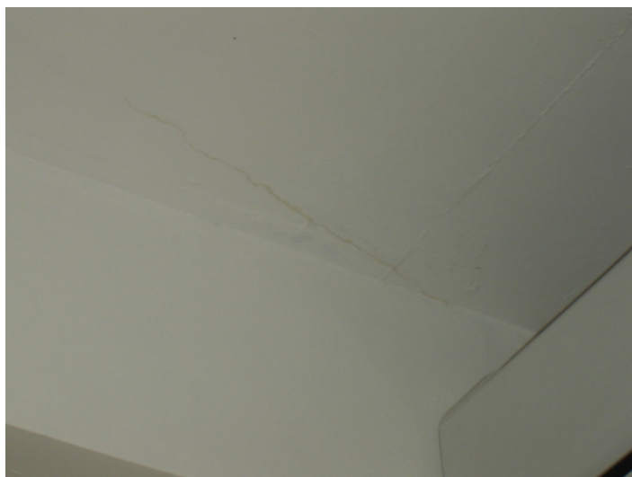
Foto 136 – Infiltração e fissura.
