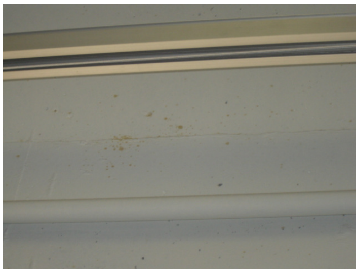
Foto 68 – Infiltração na viga.
