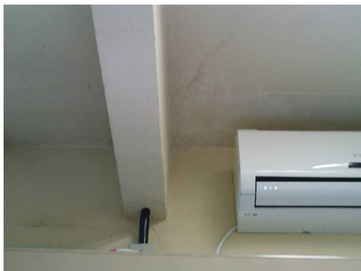
Foto 106 – Infiltração próxima ao ar condicionado.
