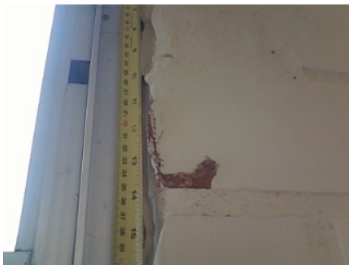
Foto 75 – Infiltração no tijolo.
