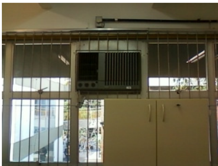
Foto 36 – Ar condicionado antigo com fechamento em placa de alumínio.
