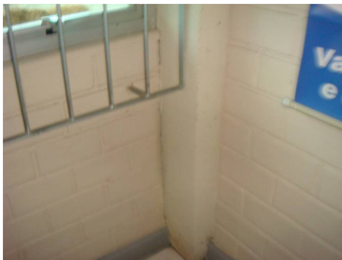
Foto 10 – Fissura de 75 cm de altura.
