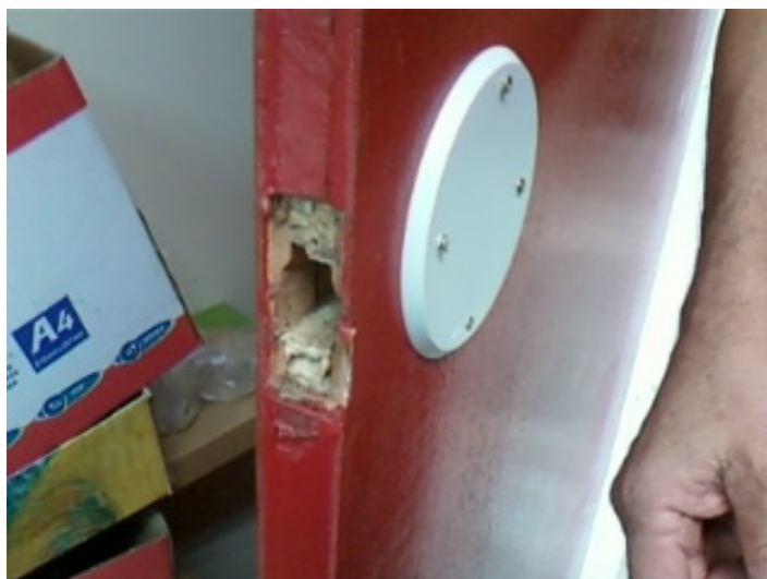
Foto 58 – Porta com alteração de fechadura.
