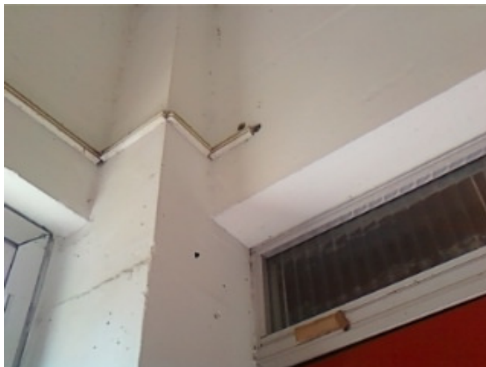
Foto 50 – Marcas na estrutura e canaleta para retirar.
