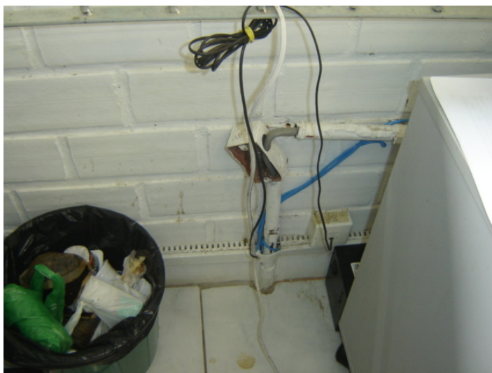
Foto 128 – Caixa de passagem danificada.
