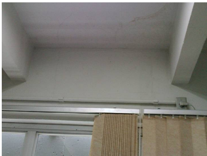
Foto 91 – Infiltração na viga.
