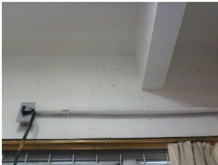
Foto 37 – Marcas na alvenaria.
