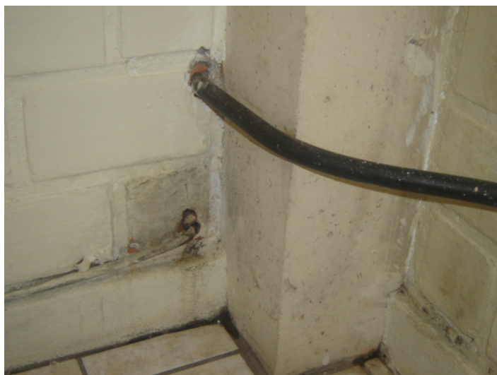
Foto 118 – Infiltração na parede.
