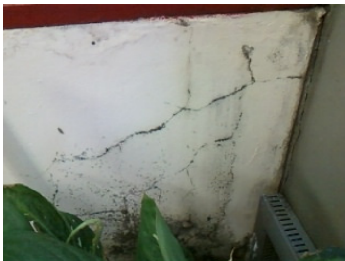
Foto 61 – Infiltração na parte baixa.
