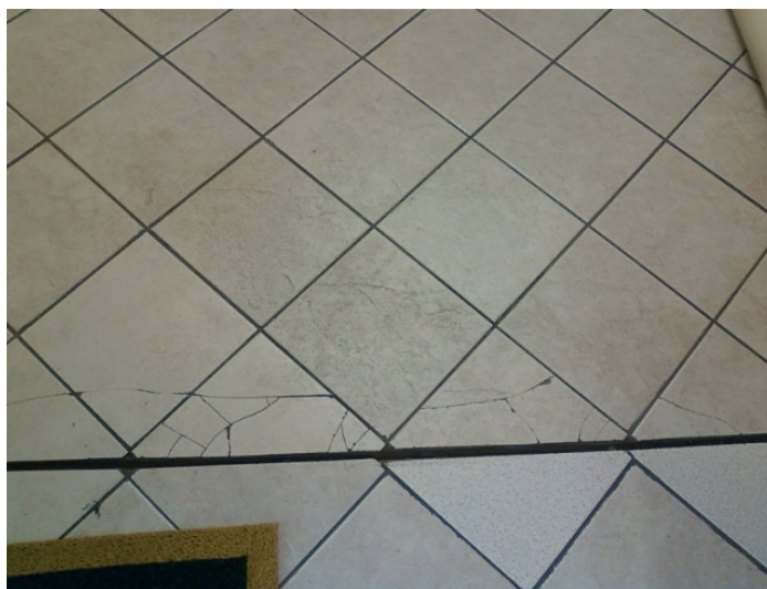
Foto 07 – Piso cerâmico quebrado.
